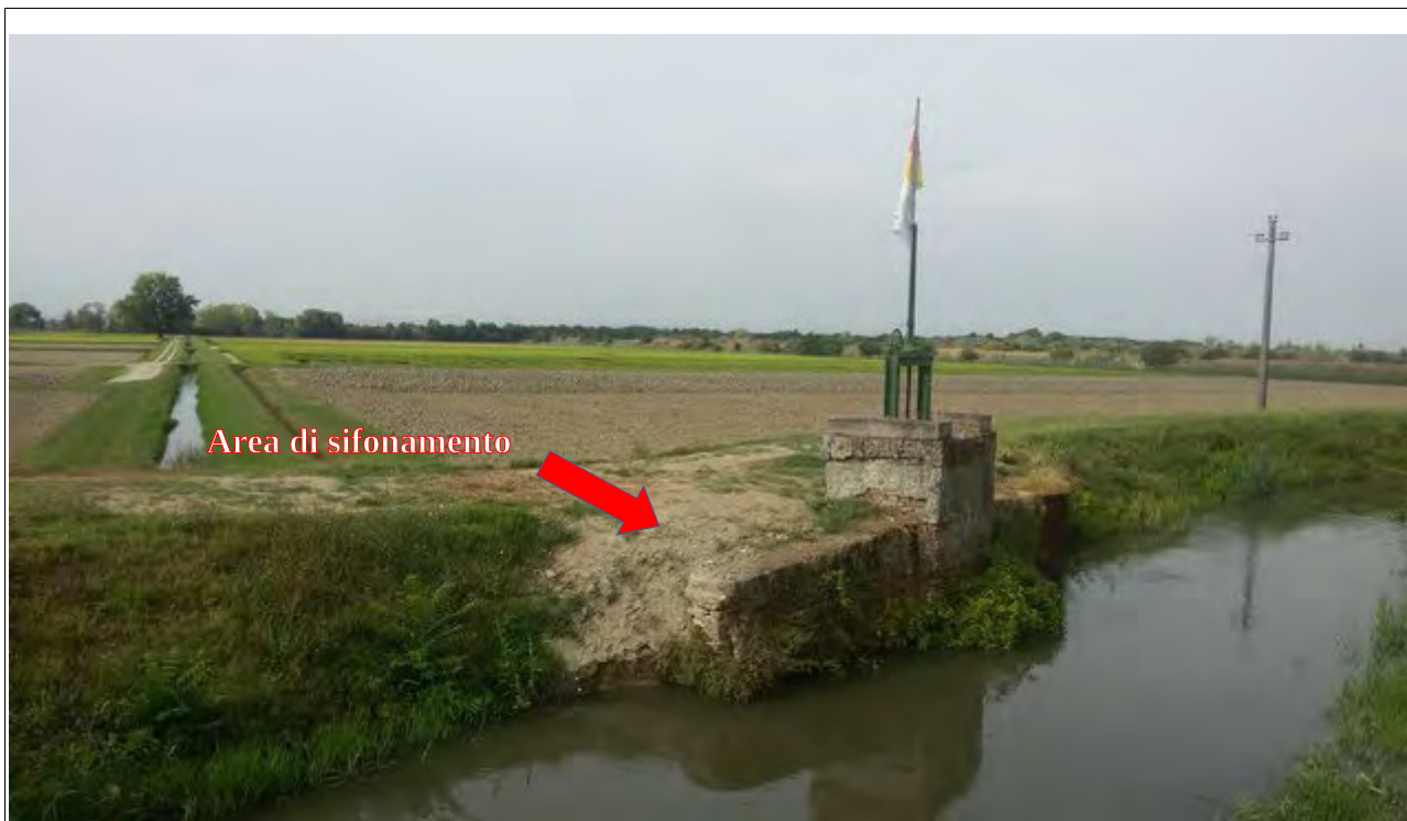
Illustrazione 4: Vista da valle del manufatto, con evidenza del punto di sifonamento.
