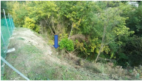
Scarico in concessione (scarico 1)
