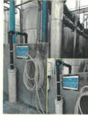
AREA COLLETTORI E LINEA DI COLLETTORI DELLE ACQUE REFLUE INDUSTRIALI PRIMA DELL'IMMISSIONE IN PUBBLICA FOGNA CON POI F 57
