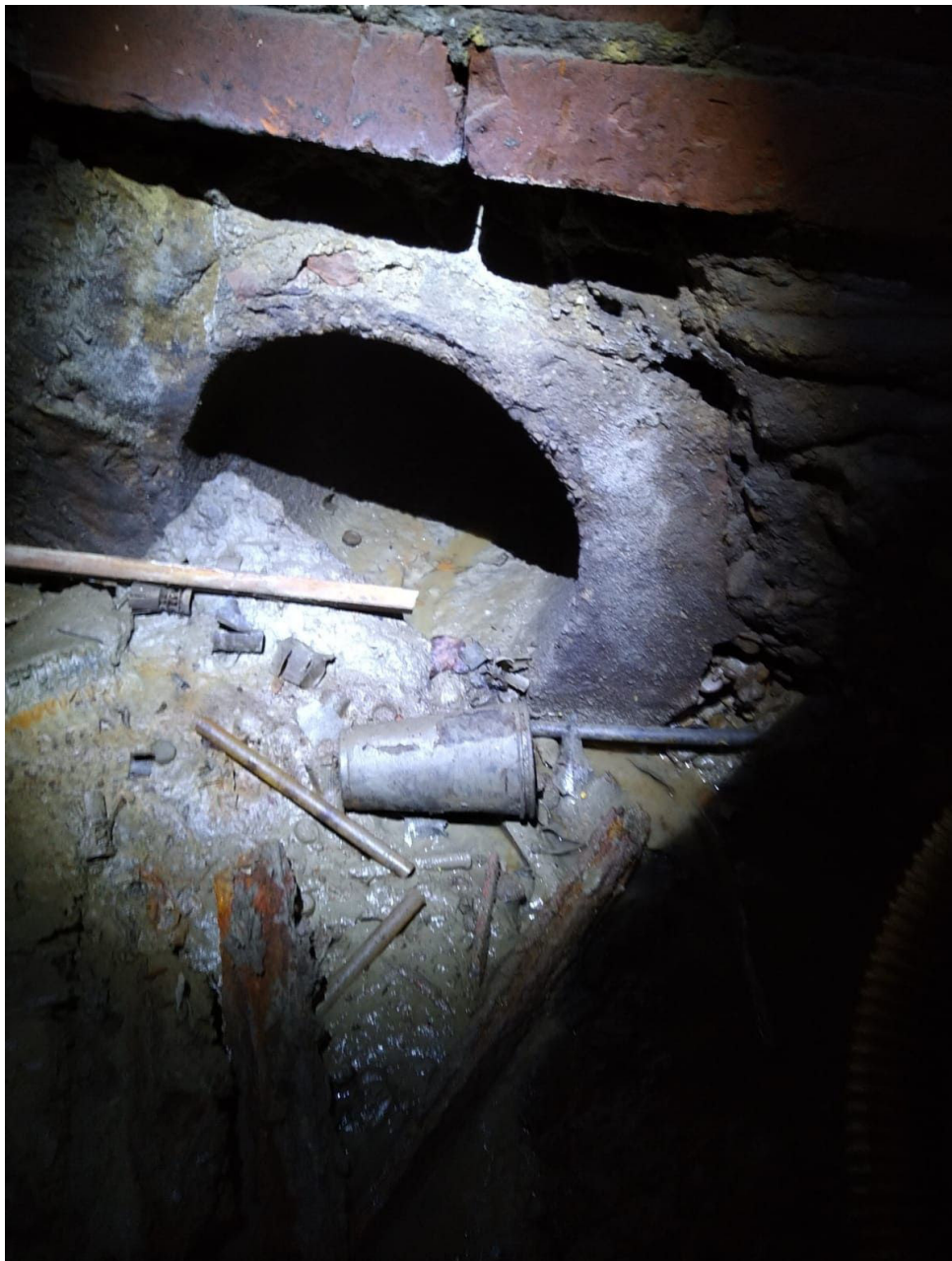
Immagine 2. Foro di uscita acque reflue dal pozzetto nel seminterrato dell'edificio A (esistente).
