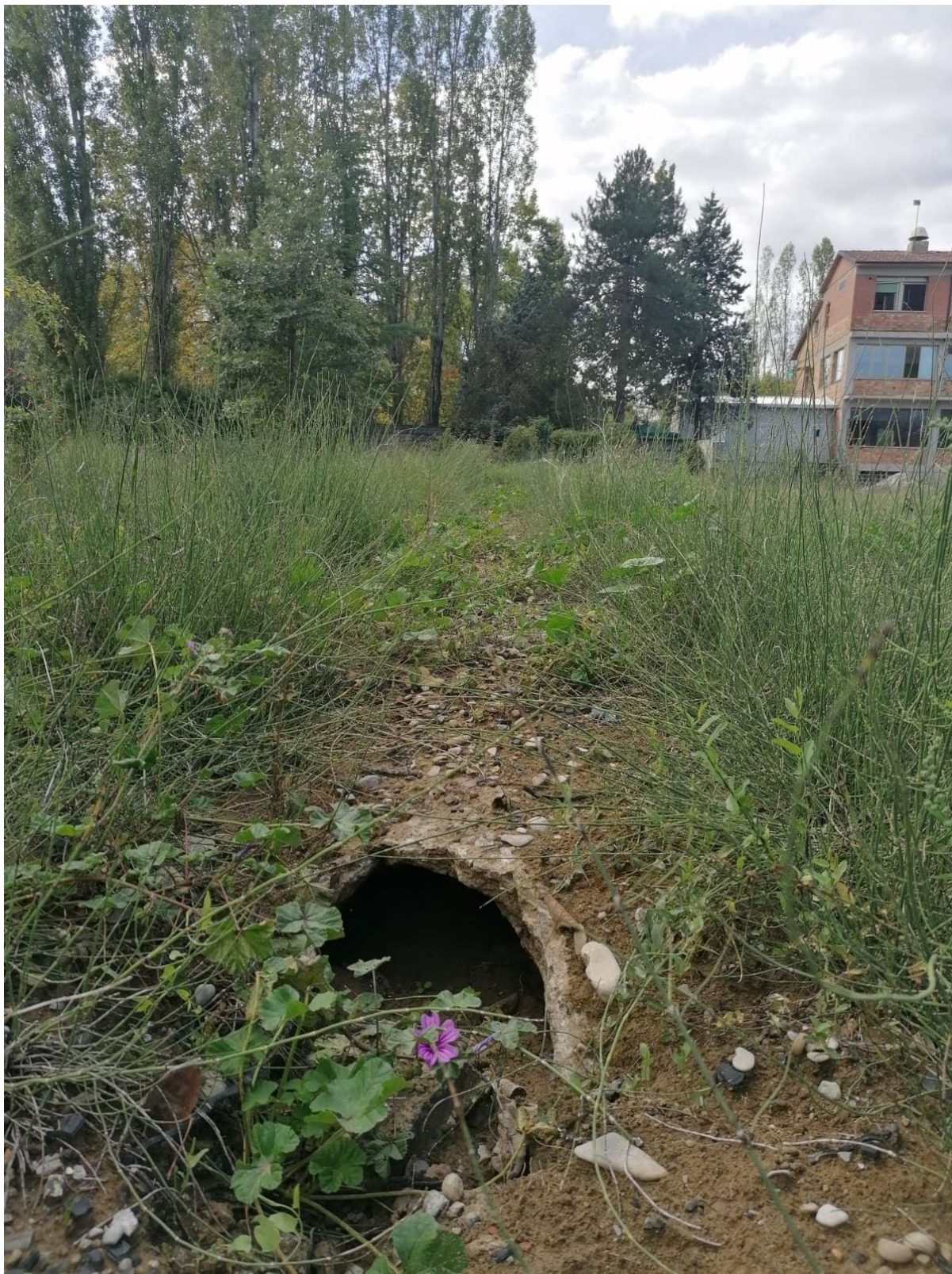
Immagine 3. Tubazione, più recente, per lo scarico di ulteriori acque reflue prodotte dalle attività legate all'edificio A (esistente).
