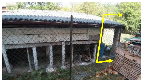
foto 2) il corpo di fabbrica, a ridosso del manufatto in lamiera, risulterebbe, nel sopralluogo del 24-08/2021, in parte in sconfinamento su area demaniale.
