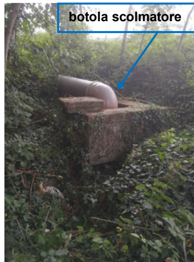
FOTO BOTOLA SCOLMATORE
