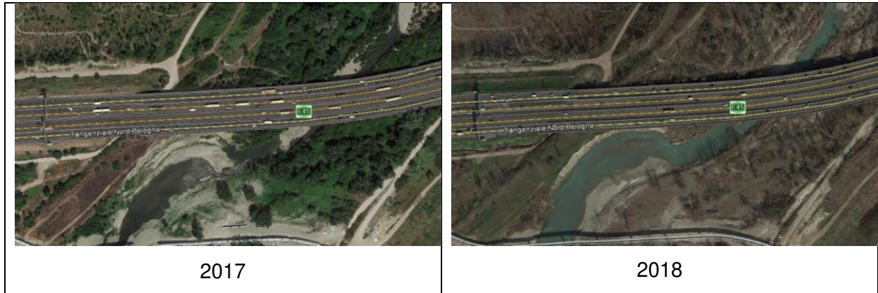
Figura 4 – progredire dell’erosione in sponda sinistra.
