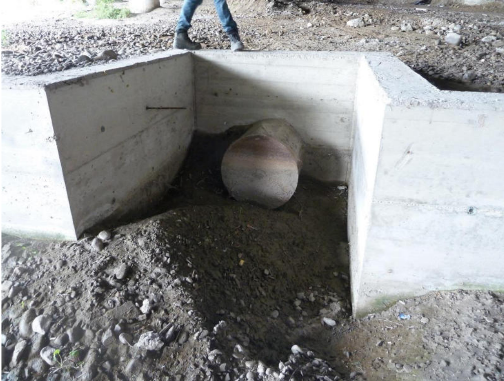
Figura 6- Sbocco con clapet della tubazione di scarico delle acque di piattaforma da ripristinare
