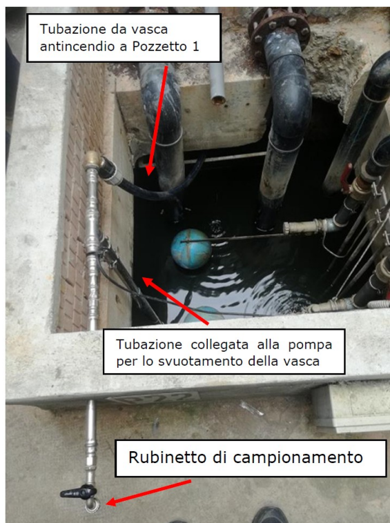
Figura 2 - Parte di vasca antincendio in cui sono presenti rubinetto di campionamento e linea di svuotamento
