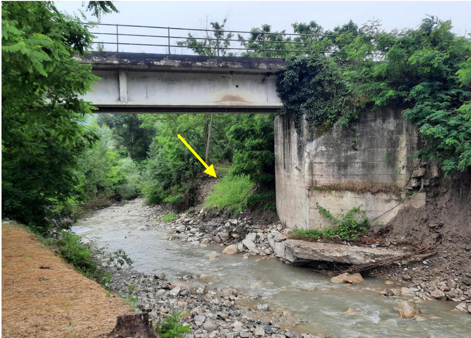
La freccia indica la pista esistente in destra idraulica per l'accesso all'alveo
