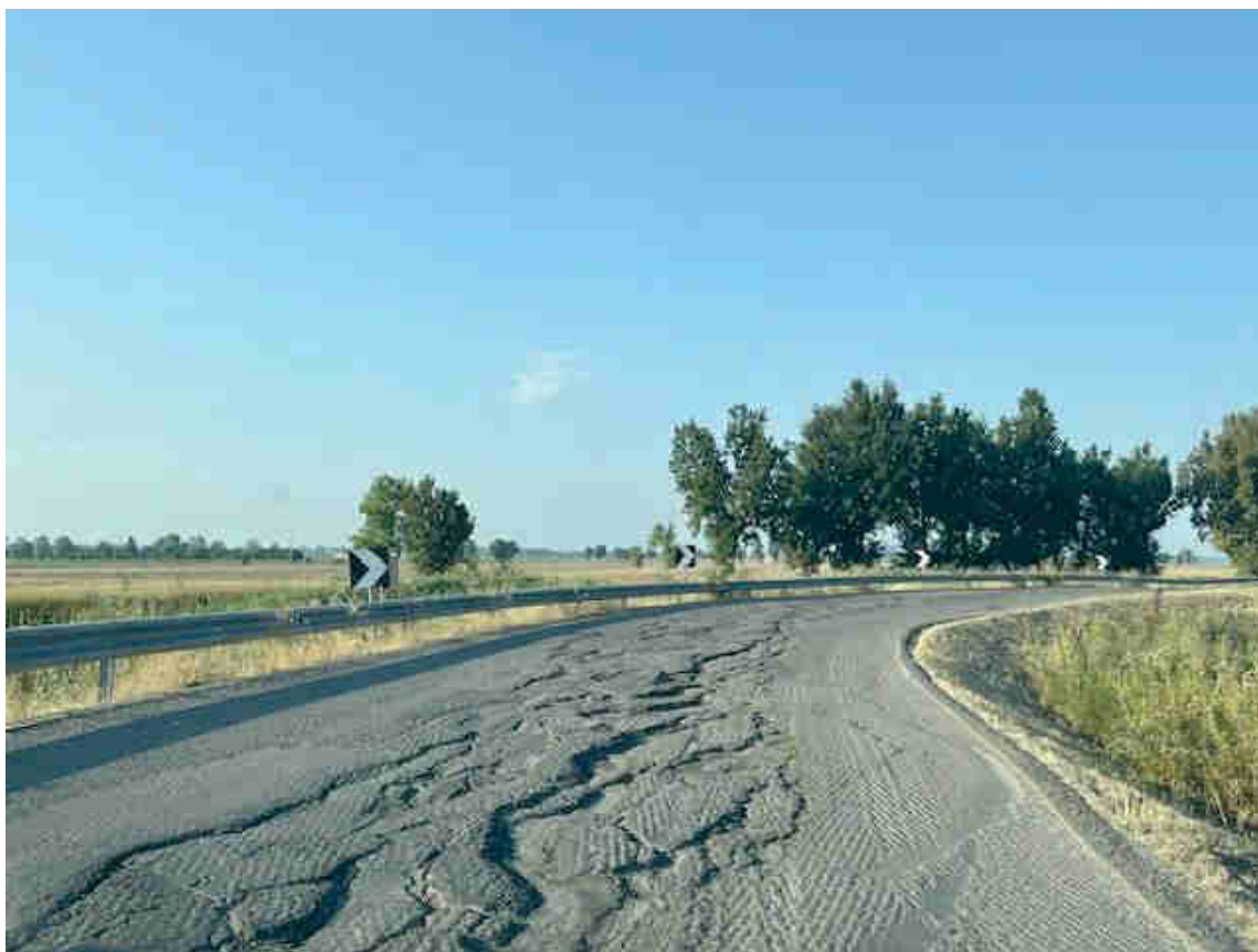
SP 33 "Argine Filippina" – stato di dissesto della carreggiata
