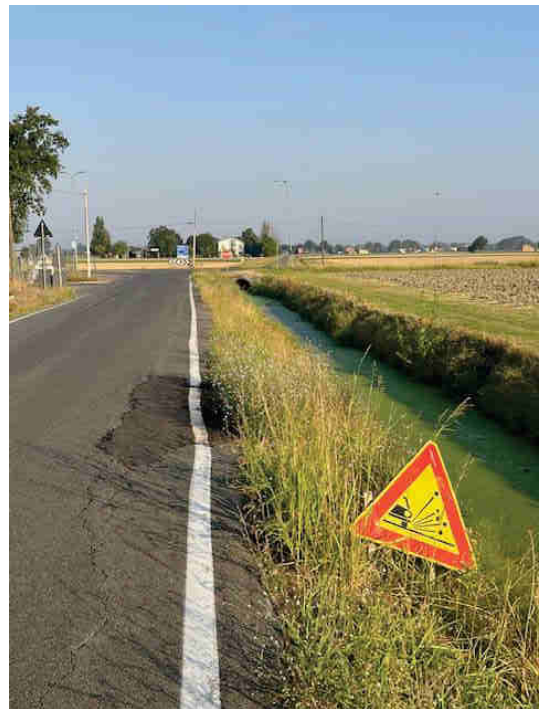
Strada dei Prati, e banchina dissestata
