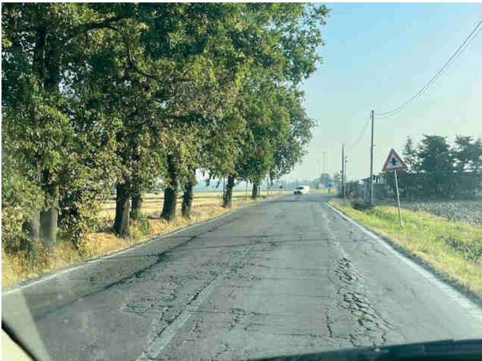
Stato della carreggiata stradale in via Ilaria Alpi
