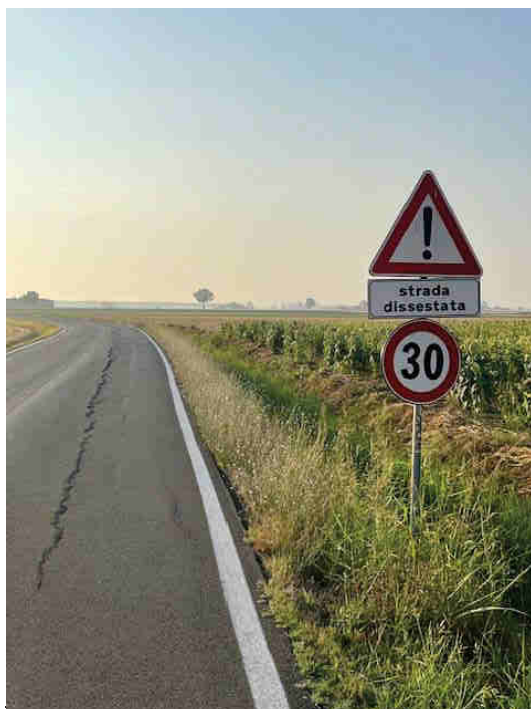
Via Gramigna, carreggiata dissestata e segnale di pericolo
