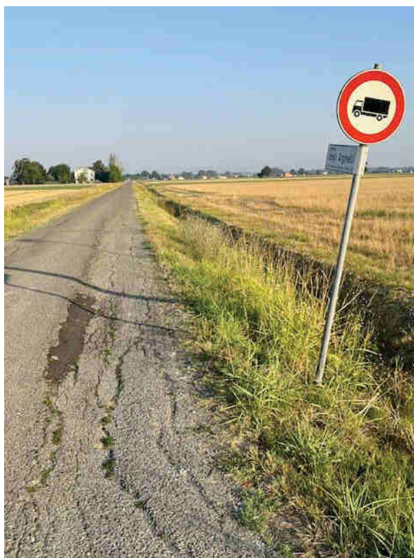
via Borghetta (oggi strada degli Arginelli) presenza del canale di bonifica, "sottofondo dissestato" e "divieto di transito autocarri"
