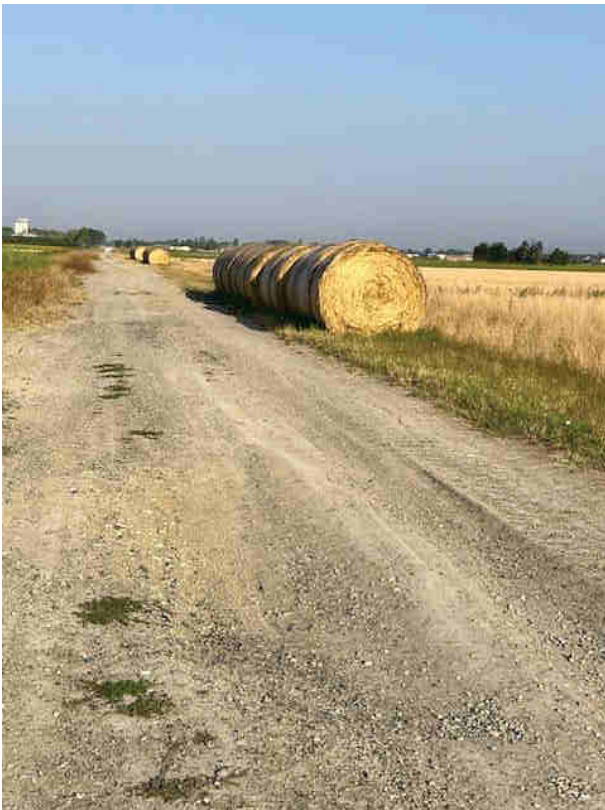
Strada Padana – secondo tratto – stato della carreggiata
