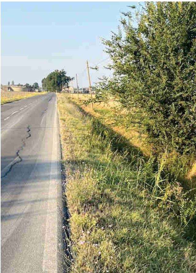
palificata "linea dati" posta sul lato ovest di via Ilaria Alpi
