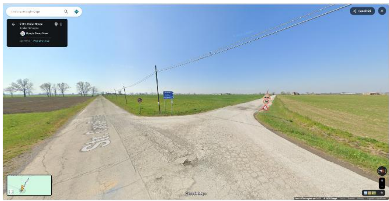
Figure 2: intersezione con Strada Casa Rossa e Strada del Martello (con divieto mezzi pesanti Strada Casa Rossa)
