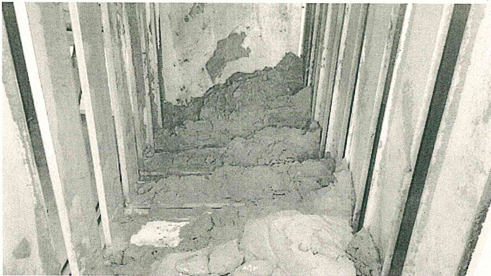
Materiale disgregato all'interno dell'UTA
