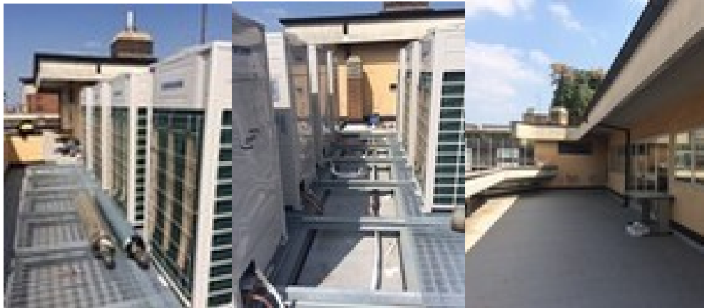
Terrazzo 8° piano "Area VRV - Regione ed Arpae" Area per pompa di calore
