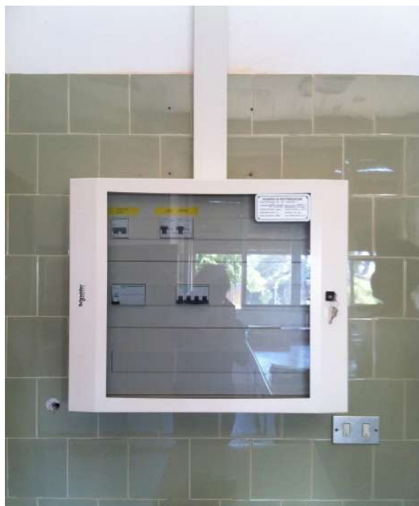
Fig. 1.3.2 – Quadro elettrico di piano
