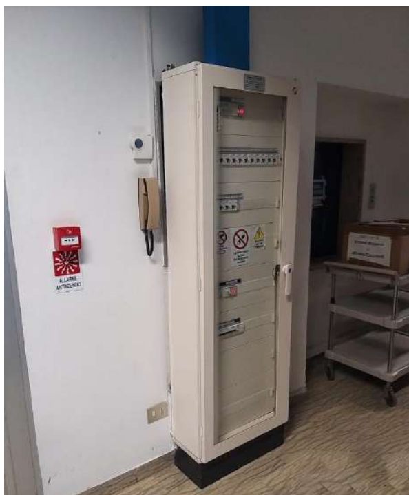
Fig. 1.3.1 – Quadro elettrico generale (P1)
