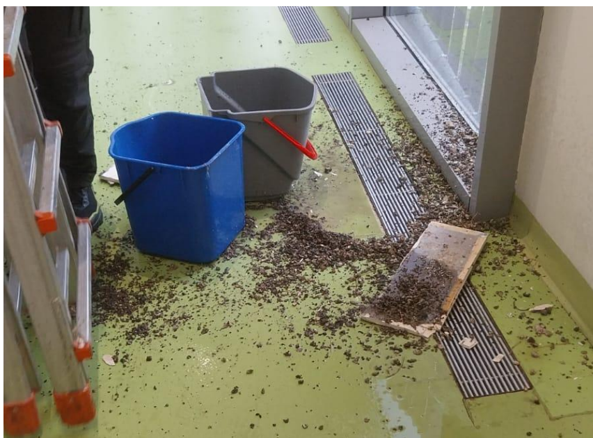
Figura 3. Guano di piccione caduto nel corridoio a seguito dell'apertura della botola del corridoio al secondo piano.
