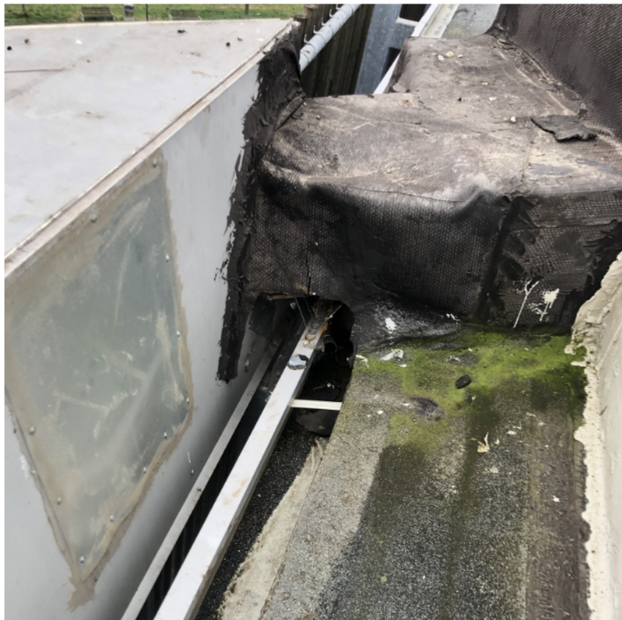
Figura 4. Dettaglio del foro di apertura che permette l'ingresso dei piccioni
