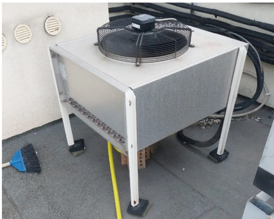
Foto 1. Unità condensante esterna da sostituire
