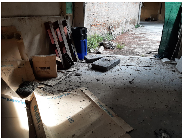
Figura 3. Guano di piccione all'ingresso del magazzino/garage
