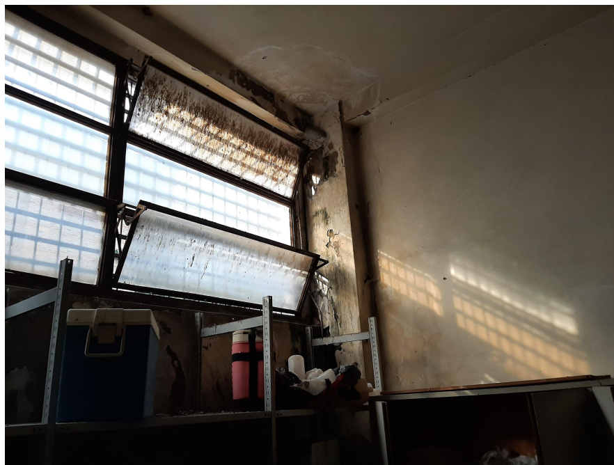
Figura 4. Dettaglio della finestra che permette l'ingresso dei piccioni
