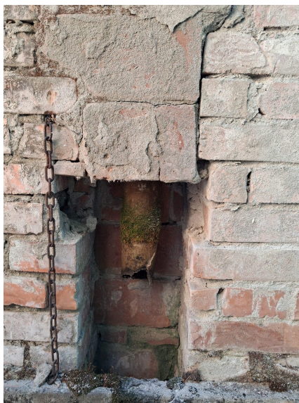
Figura 4. Condotta pluviale sottotraccia presente nel fabbricato accessorio.
