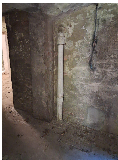
Figura 3. Tubazione in cemento-amianto presente al piano interrato.
